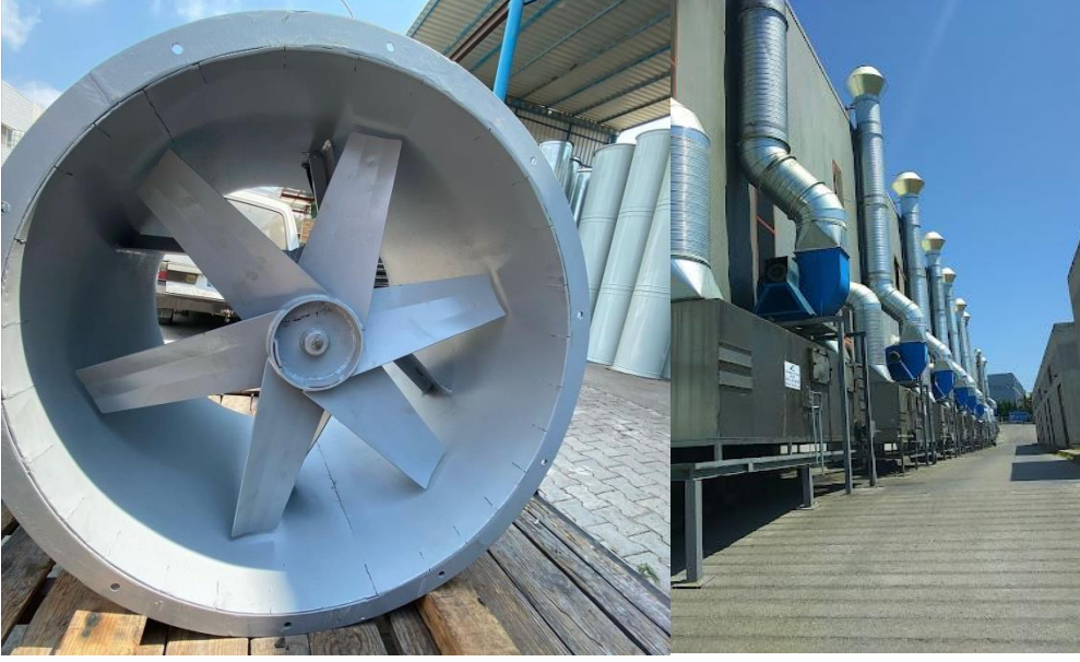
AKO KABLO –HAVALANDIRMA ve TOZ TOPLAMA SİSTEMİ HSOSB. ADANA
